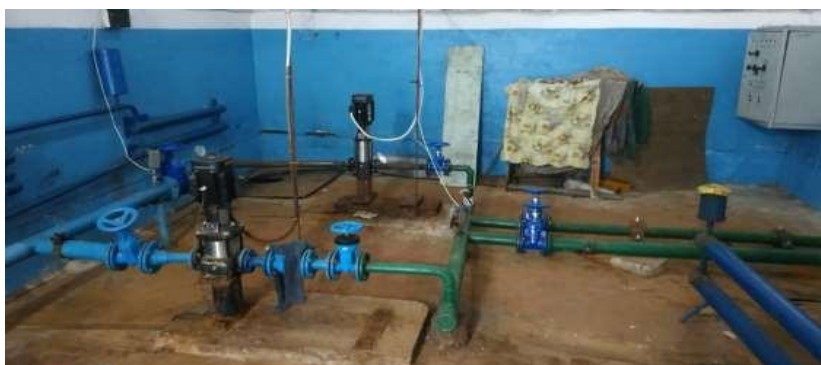
Рисунок 4.1 – Вигляд приміщення машинного залу насосної станції
