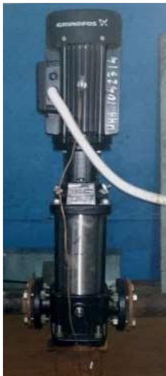
Рисунок 3.9 – Зовнішній вигляд встановленого багатоступеневого насосного агрегата
