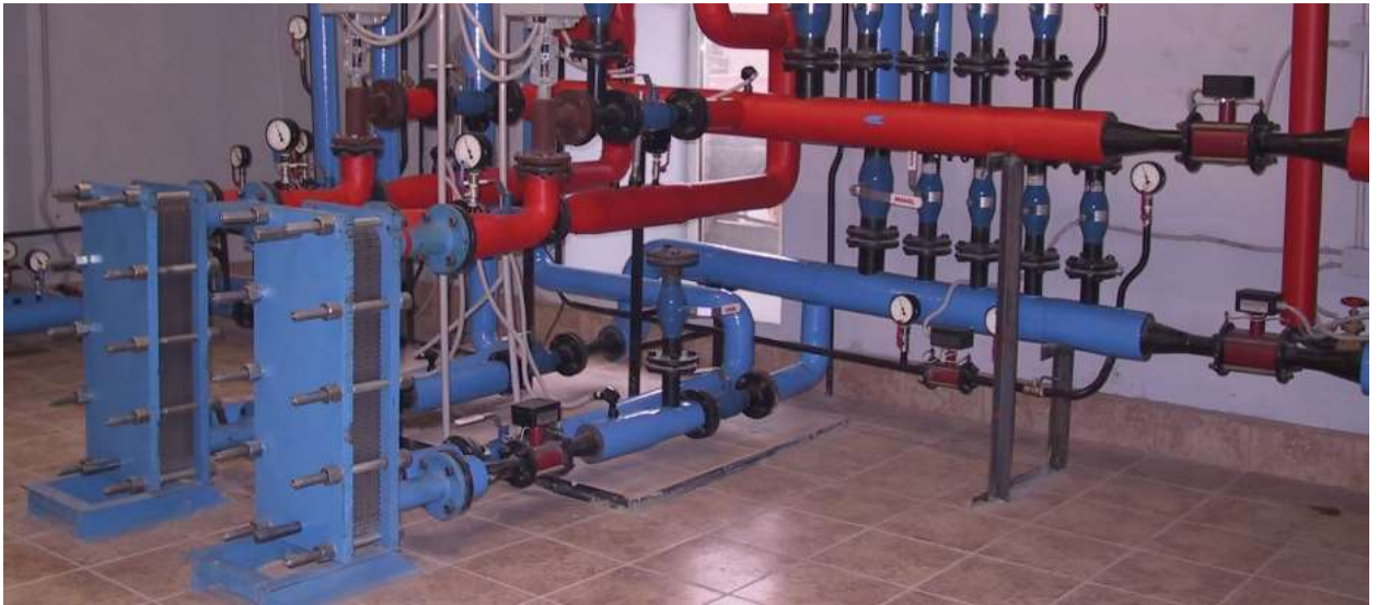
Рис 1.1 Індивідуальний тепловий пункт
