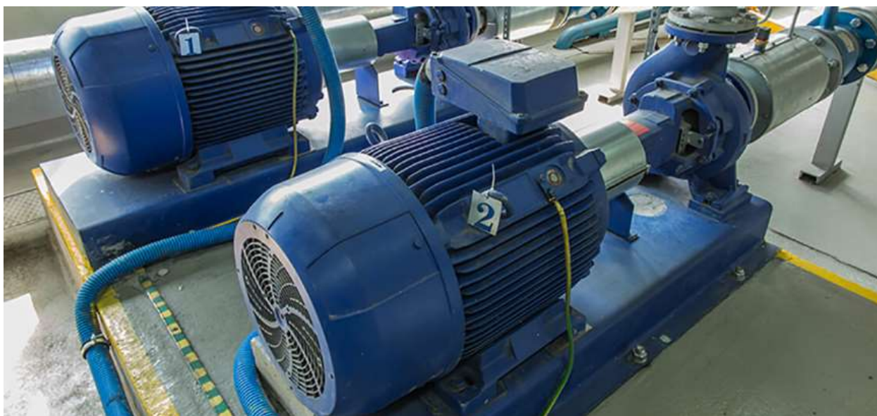
Рис 1.3 Насосні агрегати ІТП
